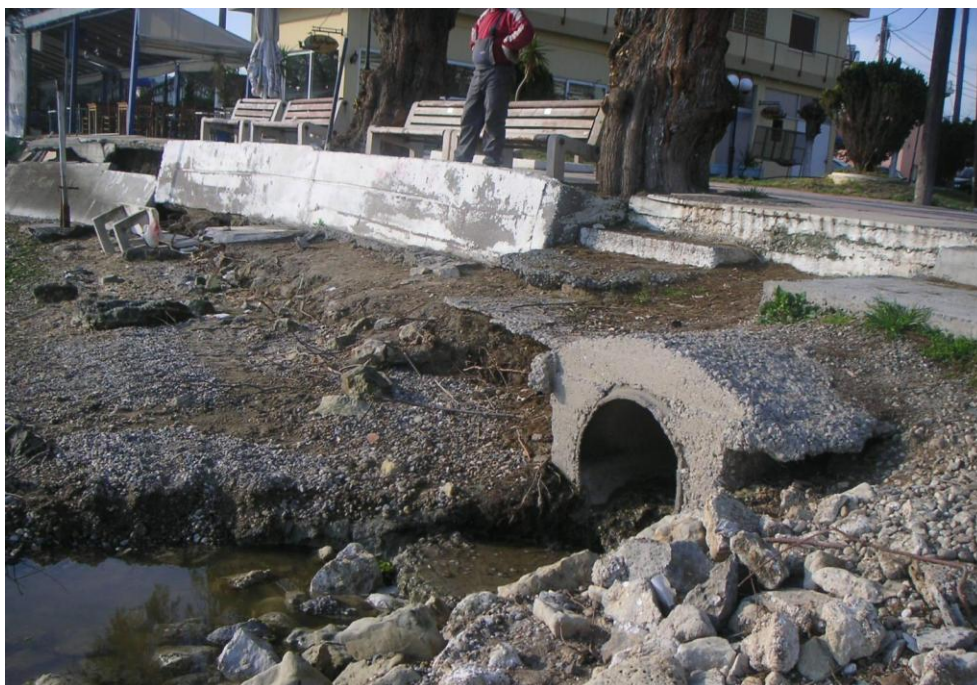
(φωτ.5) αγωγός ομβρίων
