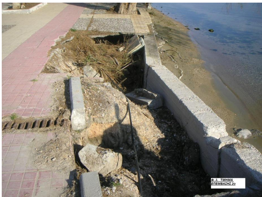
(φωτ.2) κατεστραμμένα τοιχία - οδοποιία
