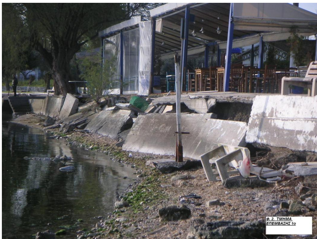
(φωτ.3) κατεστραμμένα τοιχία
