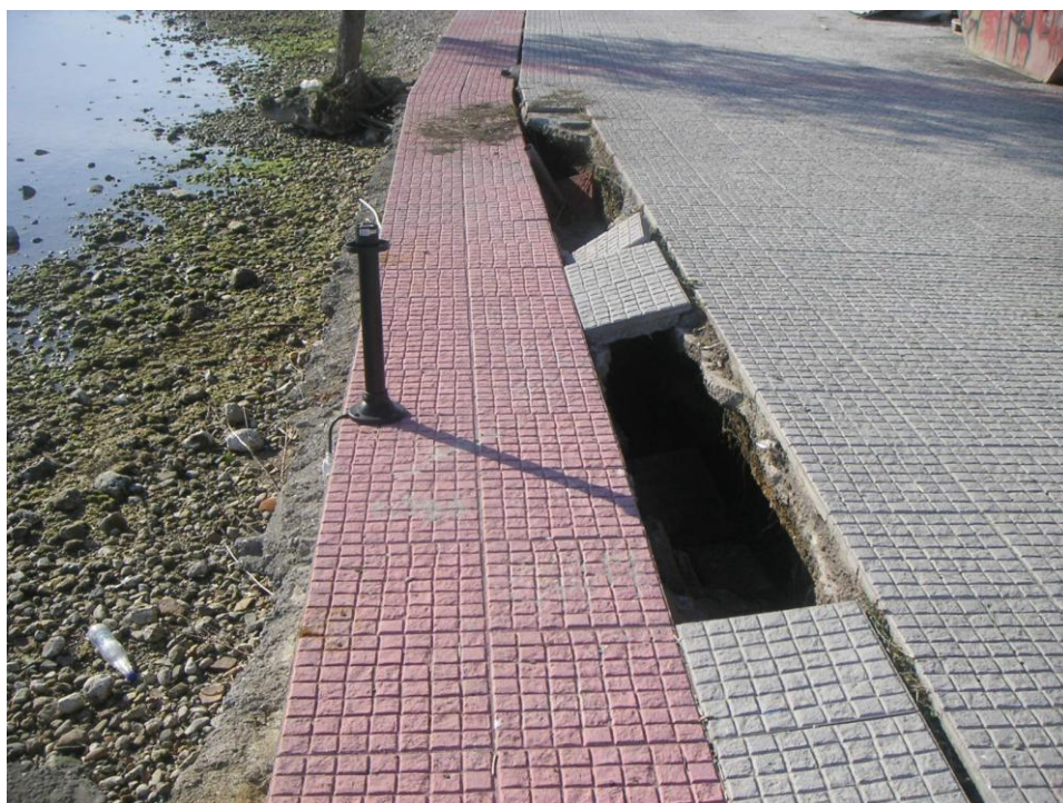
(φωτ.9) καθίζηση πλακόστρωτου
