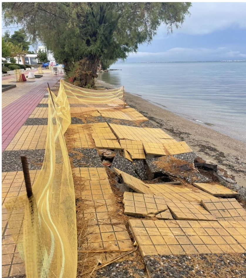
(φωτ.6, 7, 8) κατεστραμμένα τοιχία και οδοποιία
