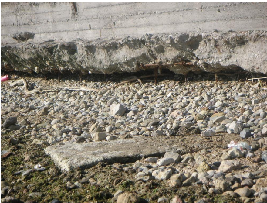
(φωτ.11) υποσκαφή της θεμελίωσης του τοιχίου αντιστήριξης και διάβρωση οπλισμού
