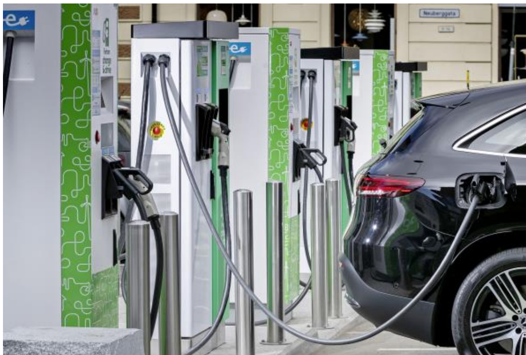
Εικόνα 1: Σημεία φόρτισης ηλεκτρικών οχημάτων (Πηγή: Google).
