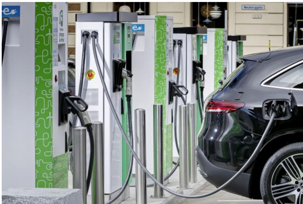
Εικόνα 1: Σημεία φόρτισης ηλεκτρικών οχημάτων (Πηγή: Google).
